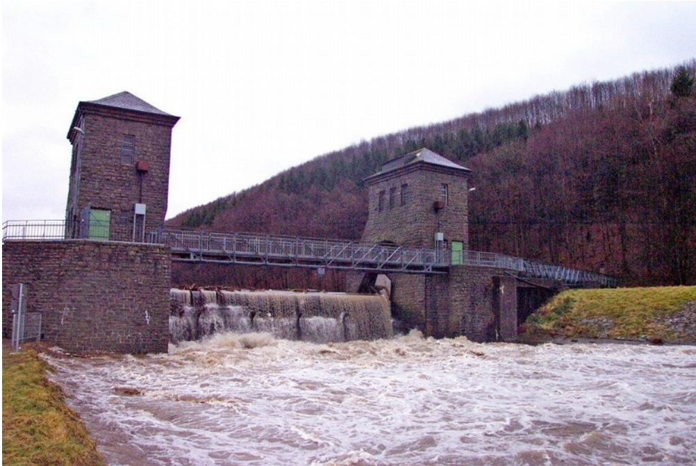
Abbildung 4: Das Verwaltungsgericht Köln hat den Betrieb der Wasserkraftanlage Ohl Grünscheid (hier das marode Wehr bei Hochwasser) wegen Gefahr im Verzug unterbunden. Zitat aus dem Beschluss: "Die - nicht weiter konkretisierten und bezifferten - Interessen der Antragstellerin (Wasserkraftbetreiber - der Verfasser), vorläufig weiterhin Nutzen aus dem Betrieb der ihr seit Jahren bekannt schadhafte Stauanlage zu erzielen, muss hinter dem öffentlichen Interesse zurücktreten, konkrete und naheliegende Schäden für erhebliche Sachwerte und möglicherweise für Leib und Leben von Menschen abzuwenden." (Bild: Friedrich Meyer).
